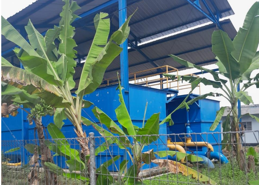
Bak penampungan air utama
